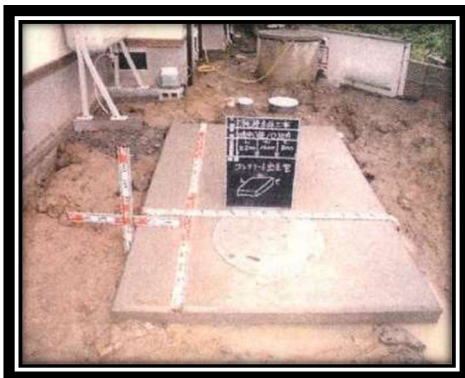
上部スラブコンクリートの状況を示す写真 スケールでコンクリートの厚さが分かるように 撮影します。
